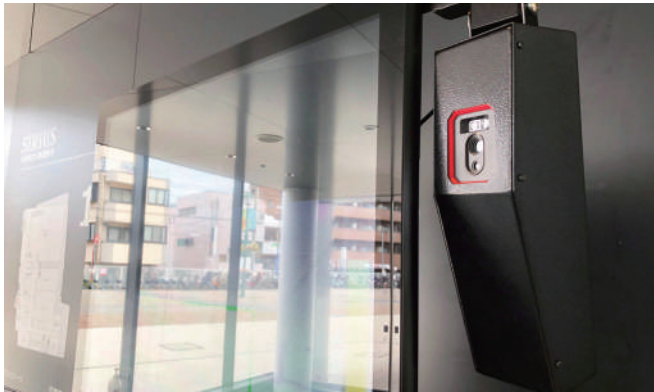
エントランス入口にサーモカメラ設置
